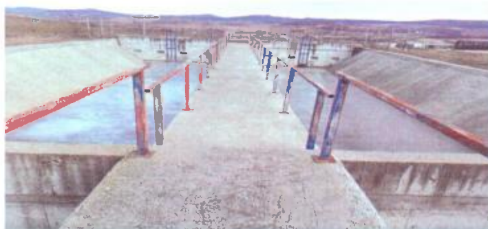
Fig. 13 – Decantor ape pluviale
