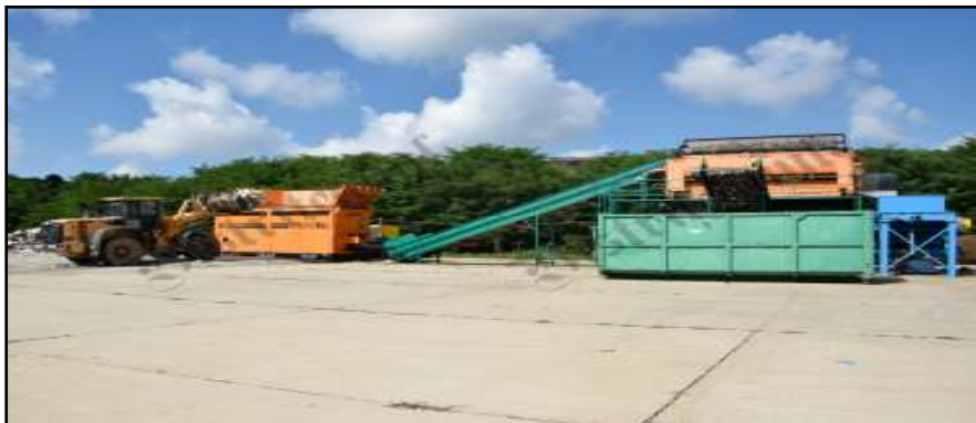
Figura 2 Instalația de tratare mecanică a deșeurilor
